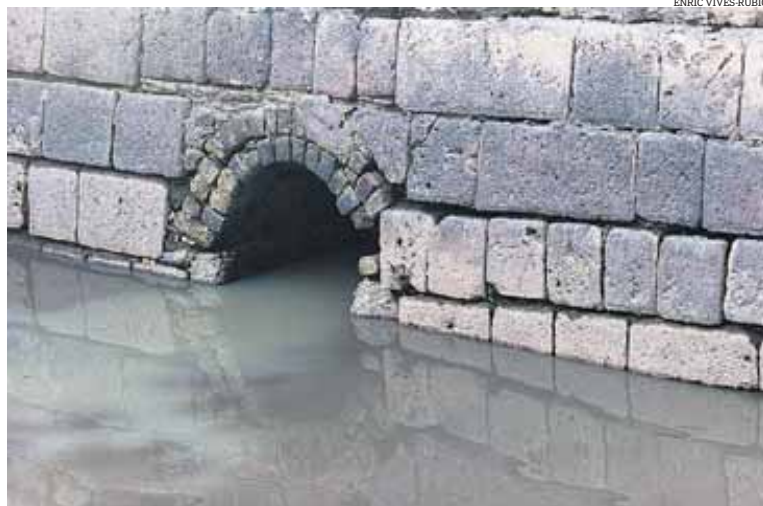
Saída de esgotos não tratados na Póvoa de Santa Iria
